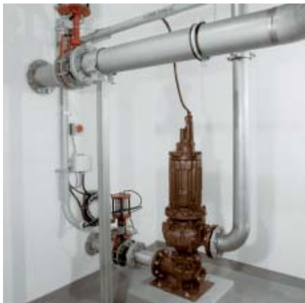
Vertikal im Trocknen aufgestellte Schlamm- pumpen mit speziellem Ansaugkrümmter
